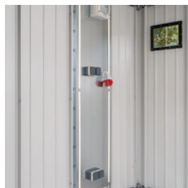
Panneau électrique avec prise de courant et éclairage
